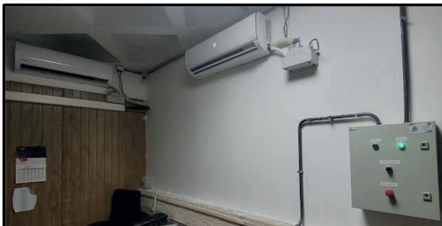
Aires acondicionados redundantes
