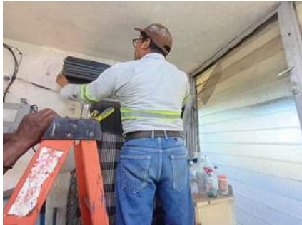
Mantenimiento de aires acondicionados
