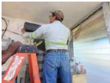
Mantenimiento de aires acondicionados
